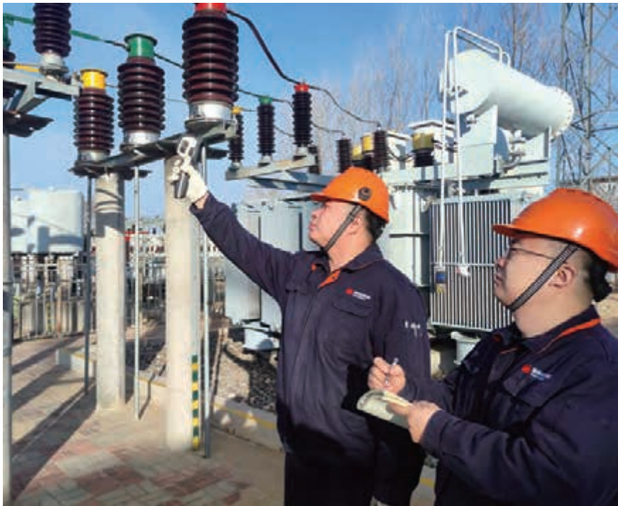
班组成员对集电环、碳刷、排碳筒等进行专项检查清理
